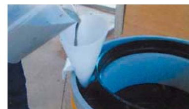
⑤铸铁枠に設けられたボルト孔よりグラウト材を流し込みます。
